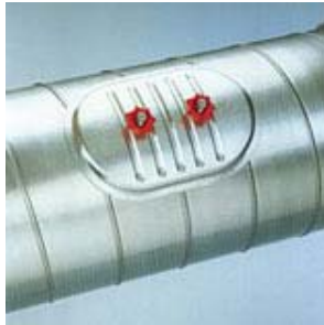
Abb. 4-4: Revisionsöffnung zur Reinigung der Kanäle
