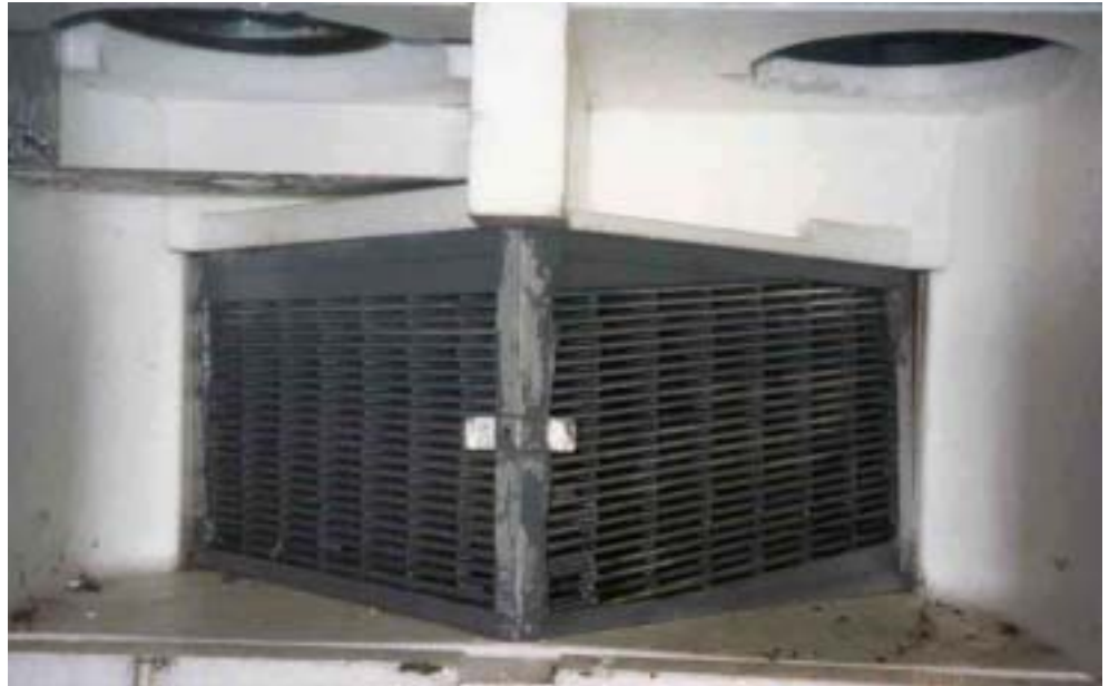
Abb. 5-4: Gebäude B, Zustand des Kreuzstromwärmetauschers
