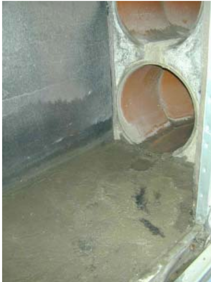
Abb. 6-13: Wassereinbruch beim Lüfterdregister, Gebäude C, Eintritt in das Lüftungsgerät
