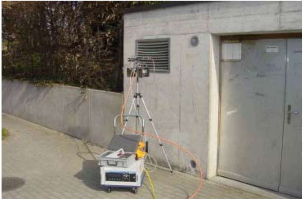
Abb. 5-2: Gebäude A, Messpunkt 1, Aussenluftfassung
