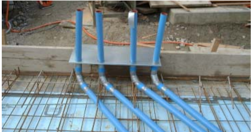
Abb. 3-7 Verteiler und Zuluftleitungen
