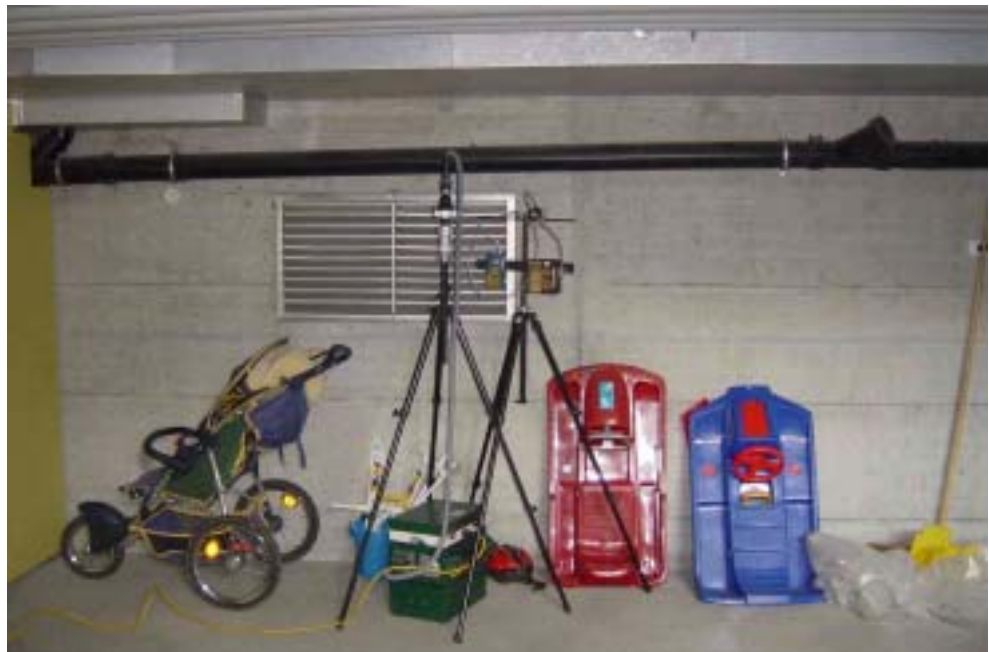
Abb. 5-7: Gebäude C, Messpunkt 1, Aussenluftfassung im Treppenschacht zur Tiefgarage
